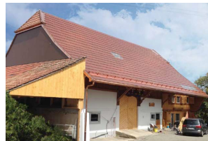
Zonnepanelen geïntegreerd in dakpannen bij een monument (Issol)
