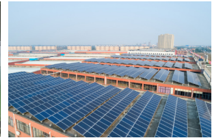
Grootschalige toepassing zon op dak (Ionindustries)
